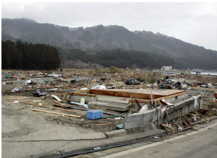
家屋が流され基礎部分だけが残る（浜川目地区・3月21日撮影）
