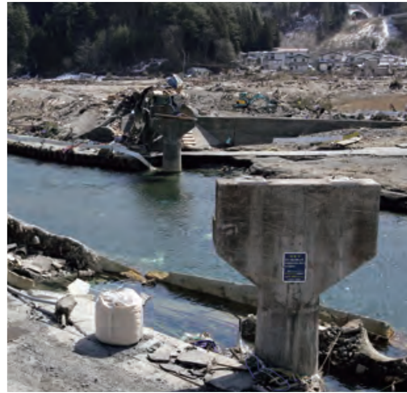
津波で流されたJR山田線の織笠鉄橋
