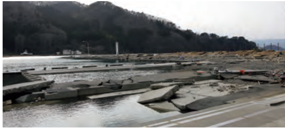
崩壊した大浦漁港
