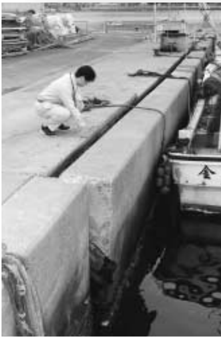
海側に20°程度傾いた織笠漁港の護岸
