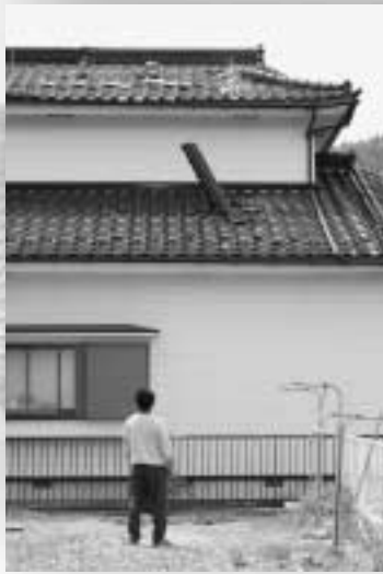
2階の屋根瓦（降棟部分）が落下し、1階の屋根に突き刺さった家屋（田の浜地区）
