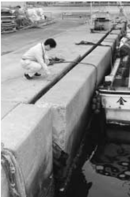
海側に20°程度傾いた織笠漁港の護岸
