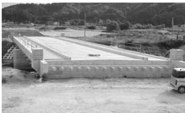
柳沢北浜地区土地区画整理事業で工事が進む「(仮称)北っ子橋」
