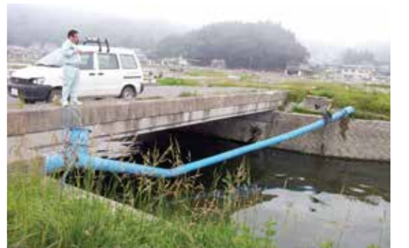
大沢地区で被災した青色の水管橋。瀬藤さんらは町内の水道設備をくまなく点検した
