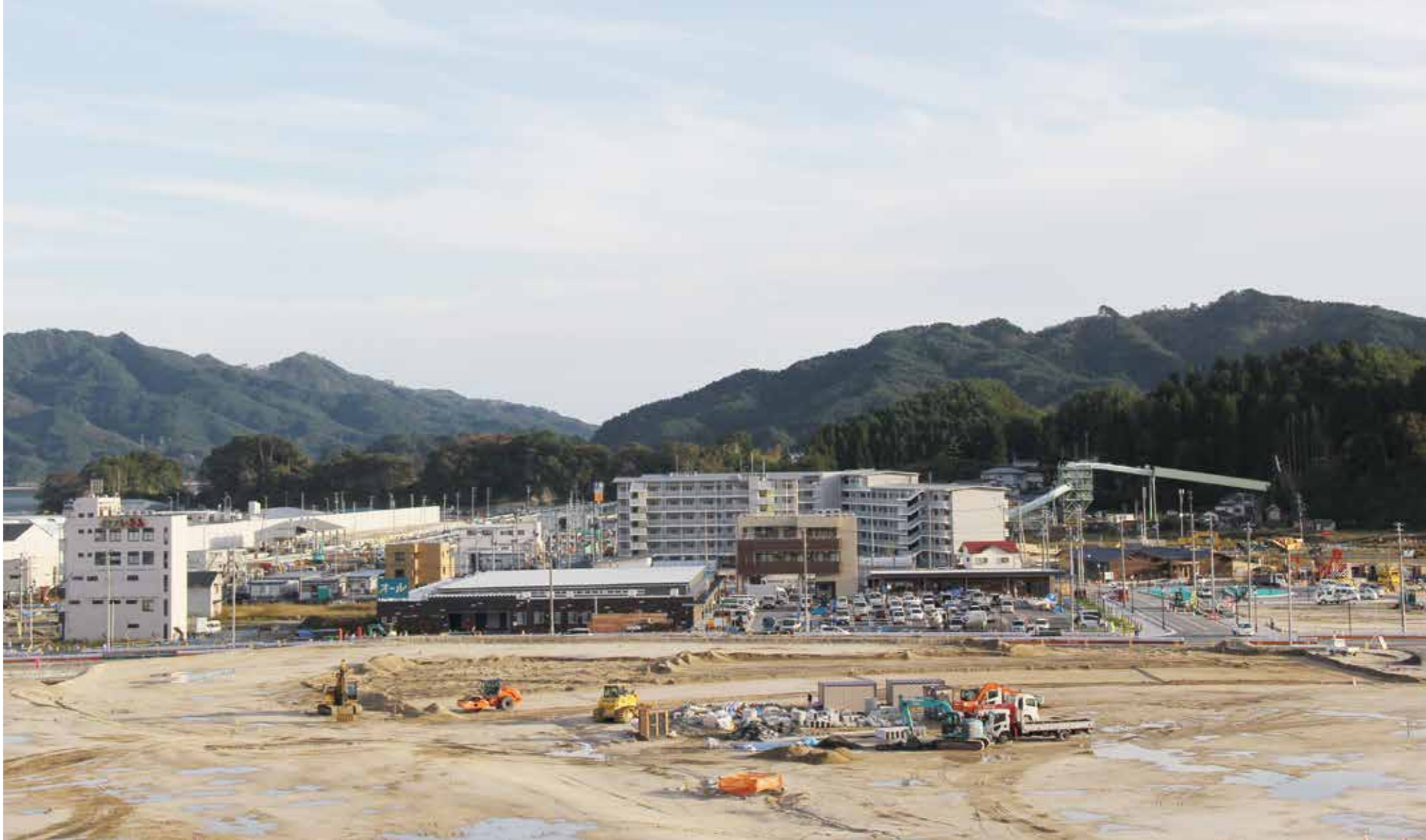
災害公営住宅や商業施設の整備が進むJR山田線陸中山田駅（休止中）の周辺（平成28年10月26日撮影）。左側の白い壁は新しい防潮堤。新しい町ができてゆく
