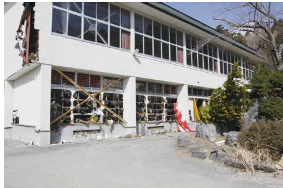
津波で外壁が打ち破られた船越小体育館（平成23年4月1日午後2時撮影）
