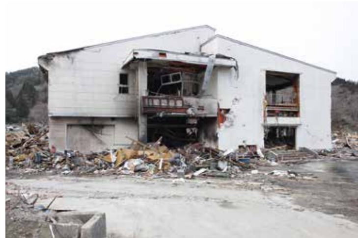
2階まで津波にのまれた上に、付近で火災が発生した船越漁村センター(平成23年3月24日午後4時43分撮影)。町指定の避難所だった
