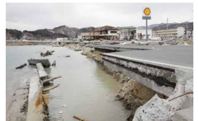
津波の威力で路盤がえぐられた柳沢地区の国道45号(平成23年3月17日午前11時55分撮影)。右奥は3階まで浸水した町営住宅
