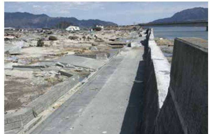
破断した織笠川左岸の堤防(平成23年3月19日午前11時49分撮影)
