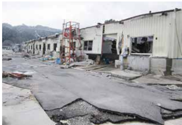
被災した織笠漁港の作業保管施設（平成23年3月23日午前10時58分撮影）。ホタテ養殖者らが使用していた
