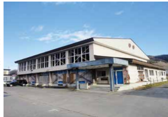
玄関部分や内部が大きく損壊した山田勤労者体育センター(被災後間もなく撮影)
