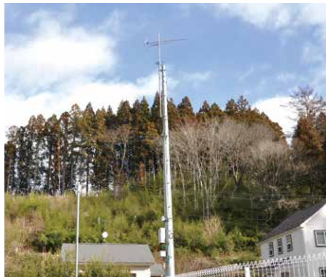
共同受信施設組合アンテナの例
