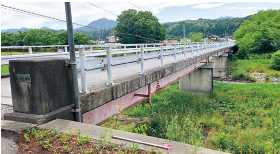
老朽化した橋脚
