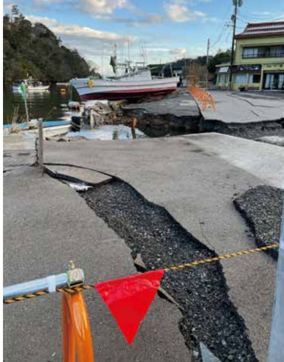
道路が陥没し、津波で船が乗り上げ(石川県能登町)
