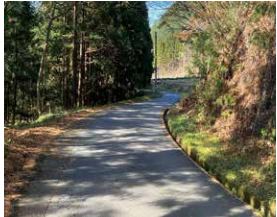
改修工事が望まれる町道福士線
