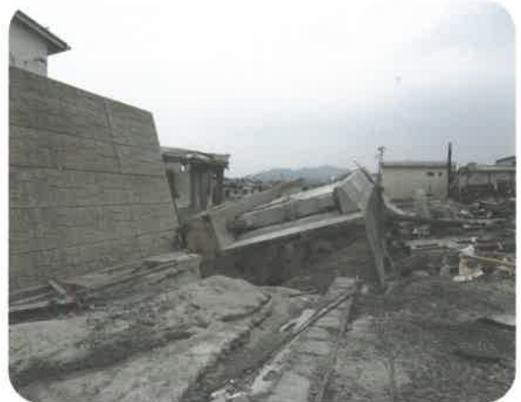
各所で堤防が破損・流失しました。
