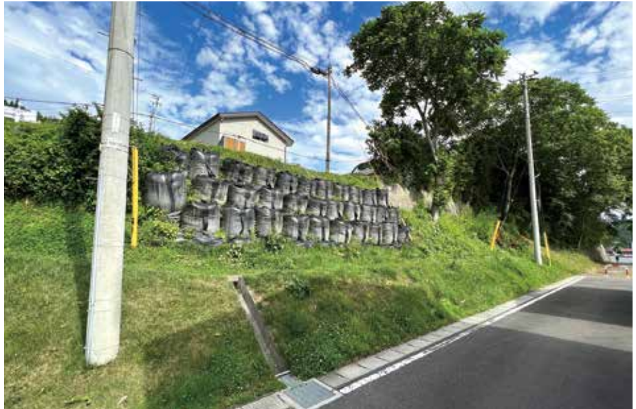
台風19号で被災した法面
