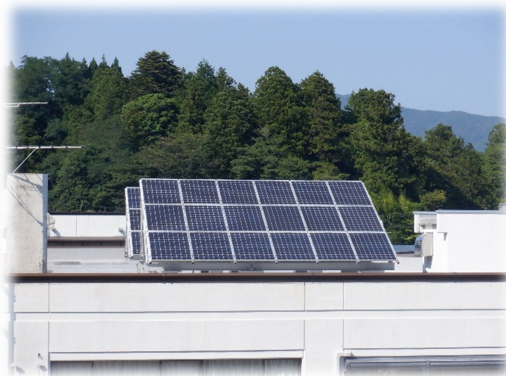
太陽光発電設備 (山田町保健センター)
