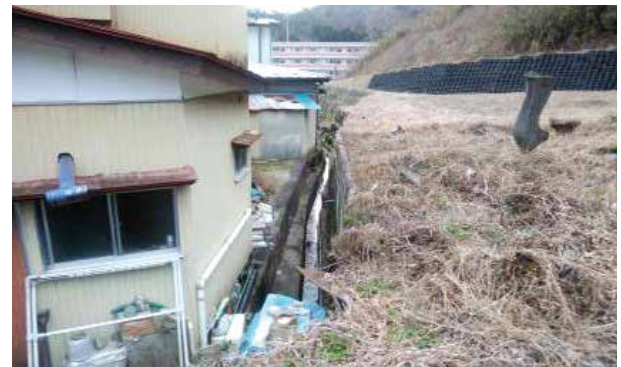
早急に整備が必要な新開地地区の水路
