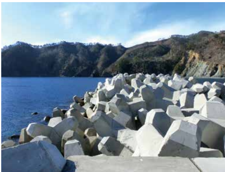
台風被害を受けた小谷島漁港
