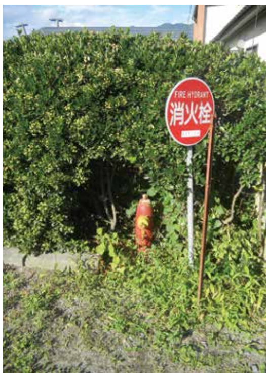
改良等が望まれる消火栓
