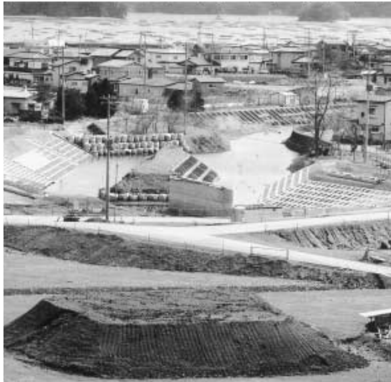
本年度の完成に向け工事が進められている「(仮称)北っ子橋」(柳沢北浜地区土地区画整理事業)
