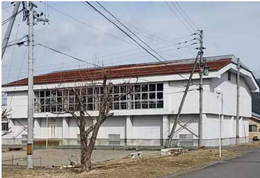
補修が必要な健康増進センターの屋根
