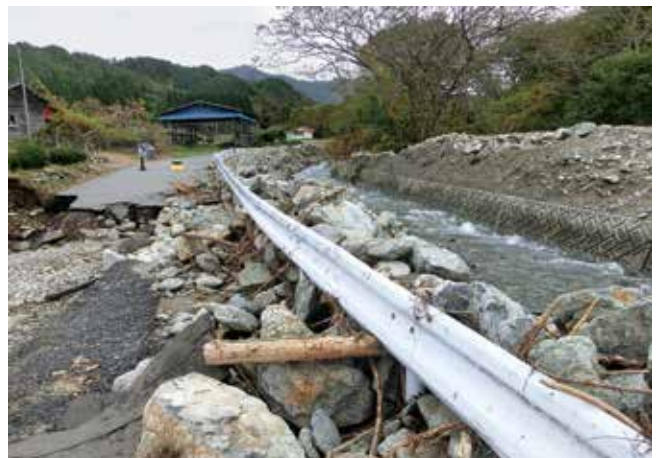
長内地区では河川が氾濫し道路が損壊
