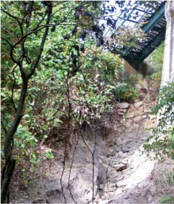
関口地区では斜面が崩壊
