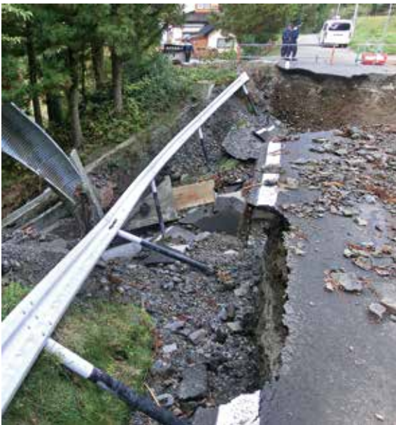
福土地区では道路が損壊
