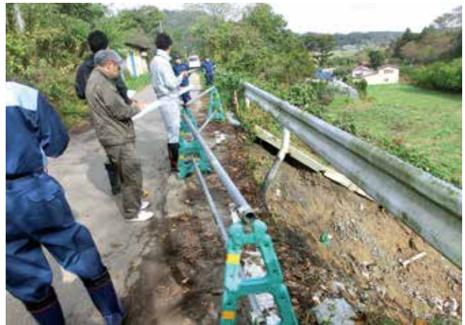
荒川地区では道路の法面が崩壊
