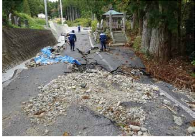
大浦地区では道路が損壊
