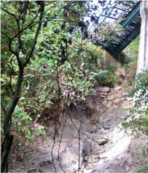
関口地区では斜面が崩壊
