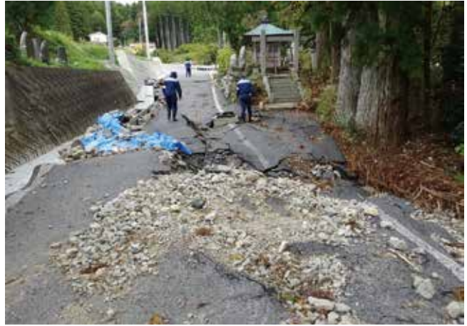
大浦地区では道路が損壊
