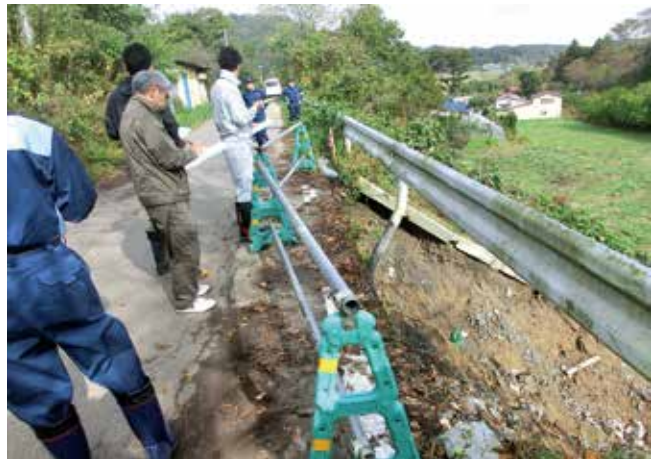
荒川地区では道路の法面が崩壊
