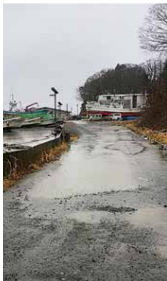
早急なかさ上げが必要な町道山の内港線
