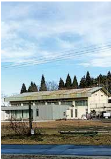
補修が必要なB & G体育館
