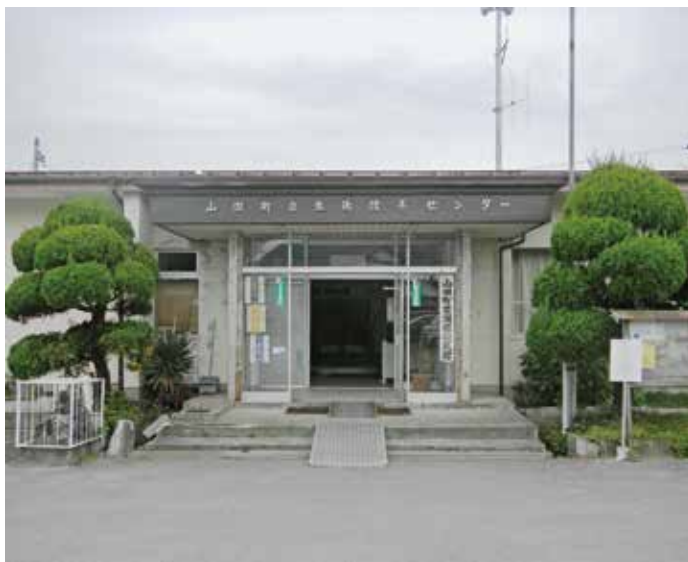
改築、建て替えが望まれる豊間根生活改善センター
