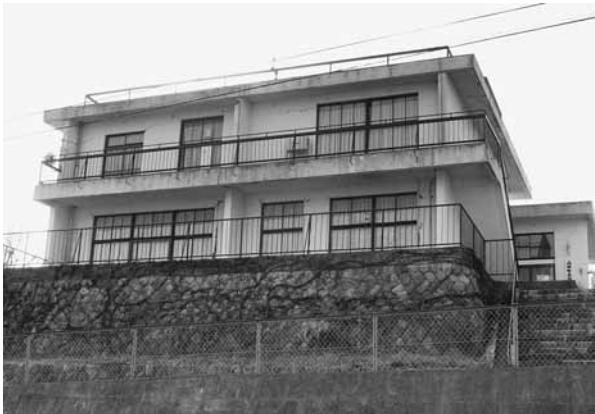
平成15年5月26日に発生した三陸南地震のあと使用を中止している町立図書館
