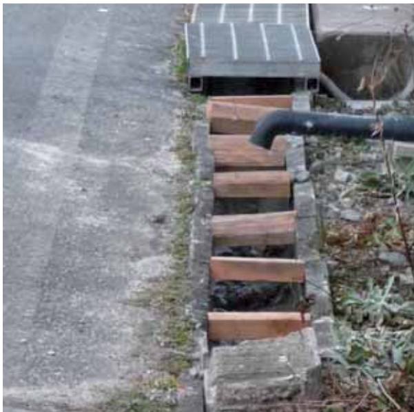
早期の整備が望まれる豊間根地区の側溝
