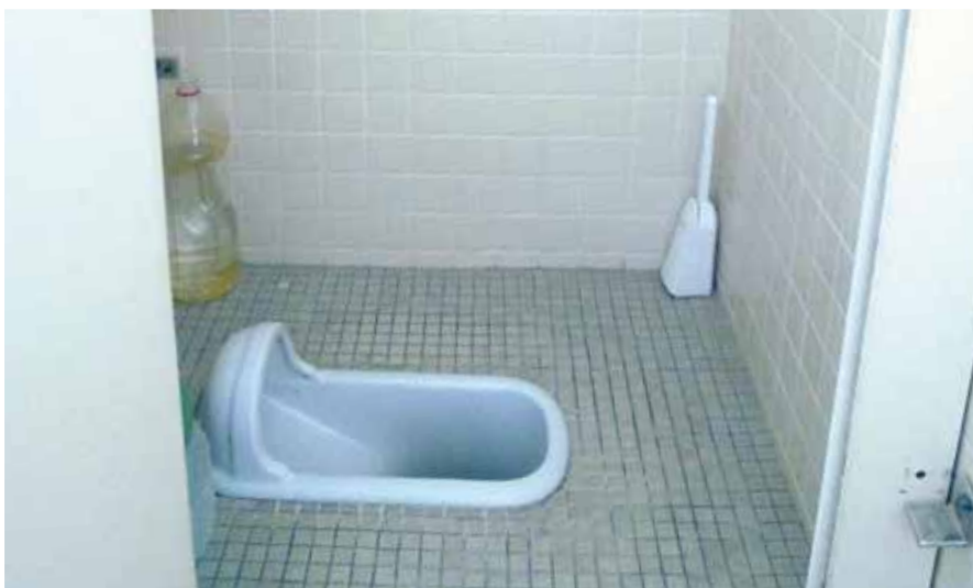
施設のトイレ改修が望まれています（写真は豊間根公民館）
