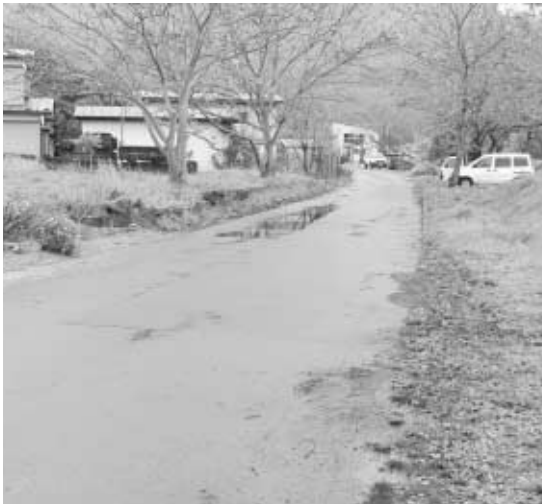
快適な生活環境づくりのため、側溝整備が望まれます。(豊間根地区)
