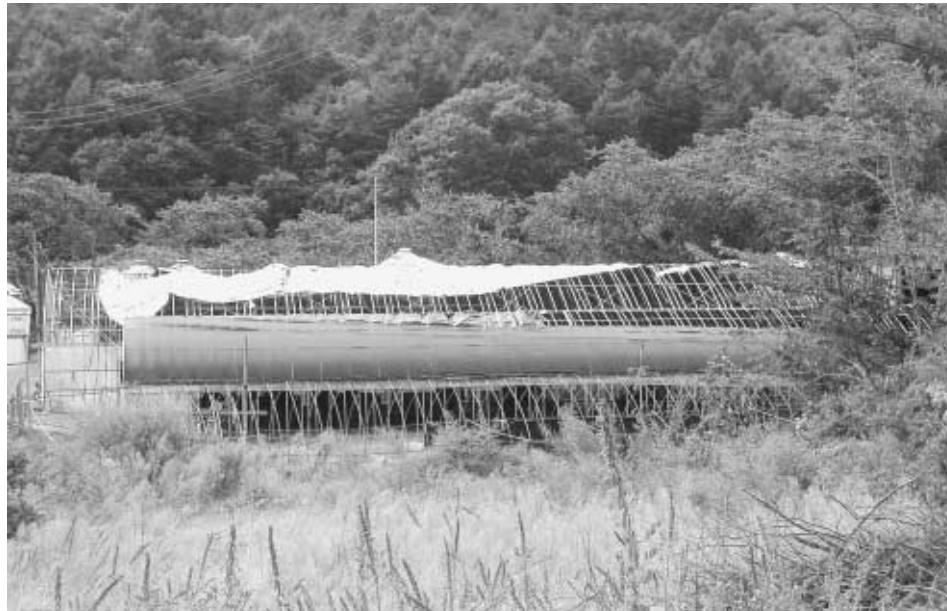
台風15号による本町でのパイプハウスの被害（豊間根地区） 今年台風の当たり年で、他県での被害はとて深刻な状況です。
