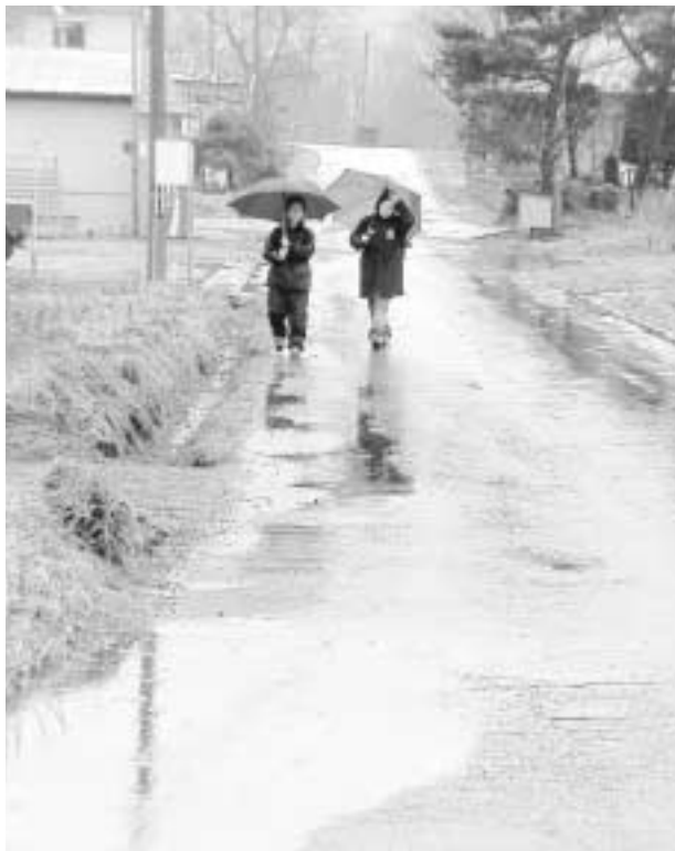
改善が望まれる嶋田地区の排水路（町道島田線）
