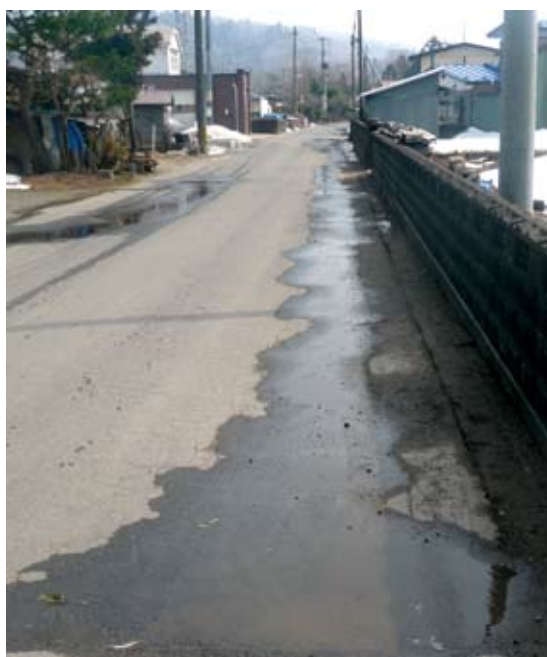
整備が待たれる豊間根地区の排水路
