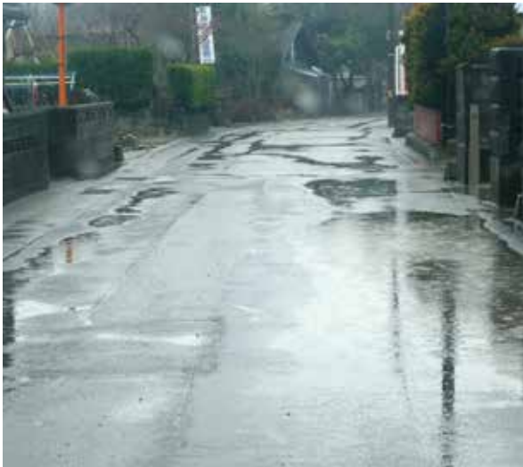
排水整備が待たれる豊間根地区
