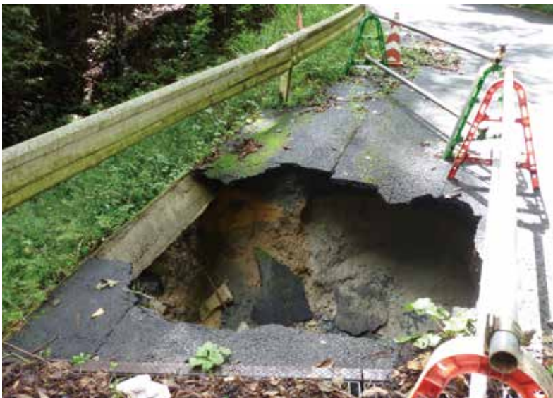
着工が待たれる台風10号の被災箇所（町道山内線）
