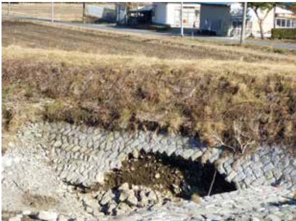
台風10号で被害を受けた堤防（豊間根地区）
