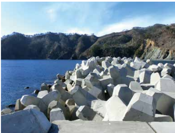
台風被害を受けた小谷島漁港
