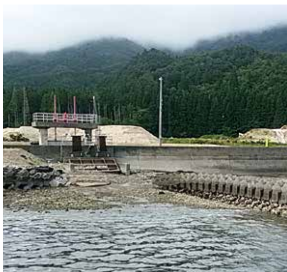
導流堤整備が必要な神倉川
