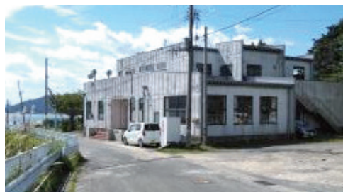
改築が望まれる大沢ふるさとセンター
