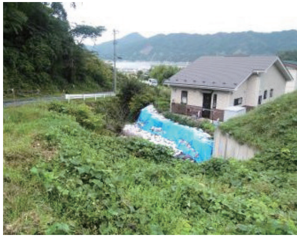
早急な改修整備が必要な準用河川女川
