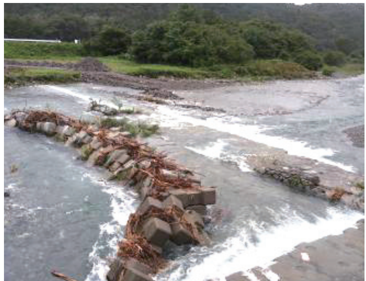
早期改修が望まれる台風19号で被災した豊間根川
