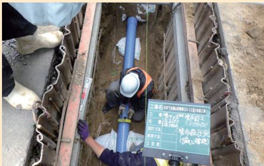
下水道は山田の川や海を守ります (写真は長崎地区の下水道工事の様子)
