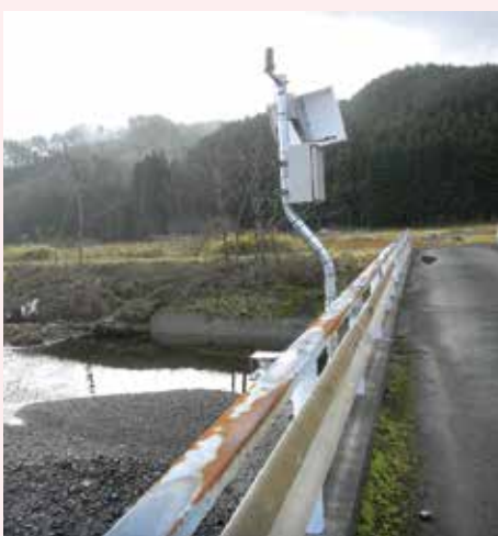
橋りように設置された水位計
