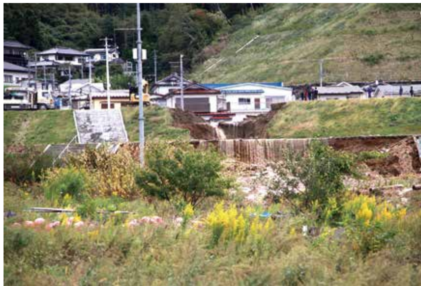
確実な排水対策が求められます (台風19号時は土手を削って排水)
