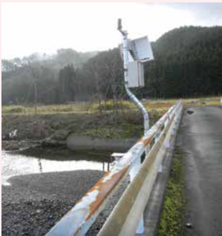
橋りように設置された水位計
