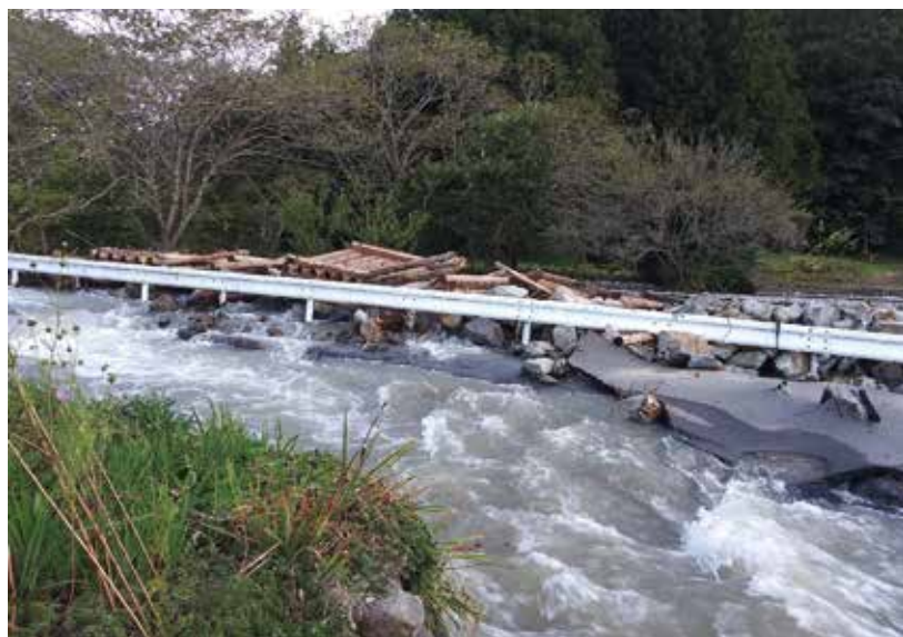
氾濫し道路が川になった長内川
