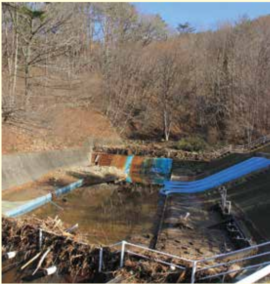
復旧が待たれるジャブジャブプール
