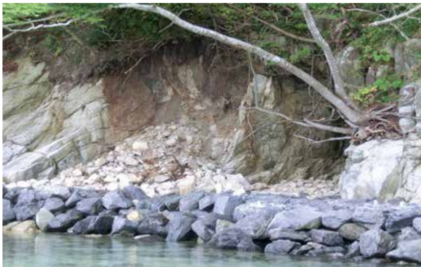
早急な整備が必要なオランダ島の土砂崩れ箇所
