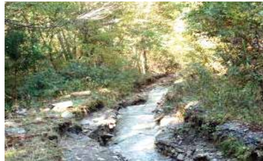
被災し道路が川ようになった草木線
