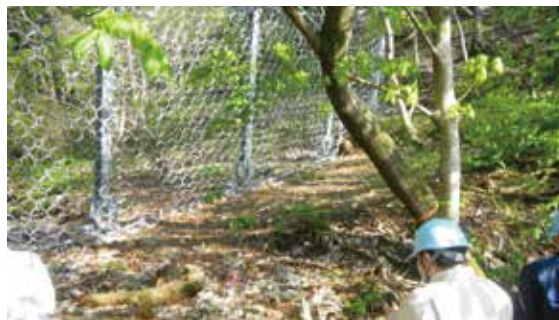
女川上流部に設置された仮設ワイヤーネット
