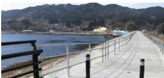
防潮堤等の安全点検を徹底し適切な管理を
