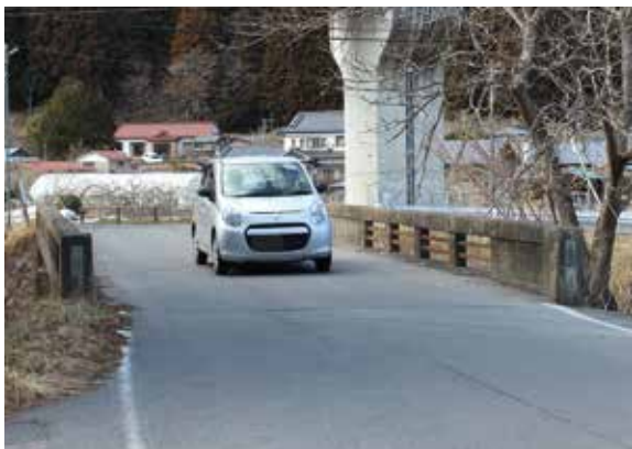
早期の拡幅整備が望まれる関谷橋 (昭和36年5月竣工)
