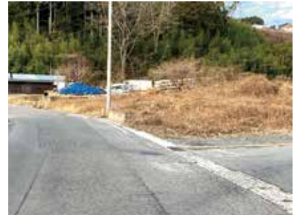
路面や側溝の損傷が見られる町道前須賀・タブの木荘線と早川1号線
