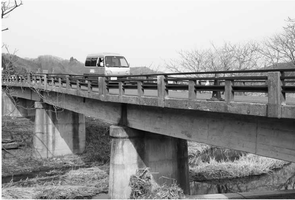
昨年12月の低気圧による大雨災害で橋面が20%沈下した馬指野橋。早急な復旧が望まれます
