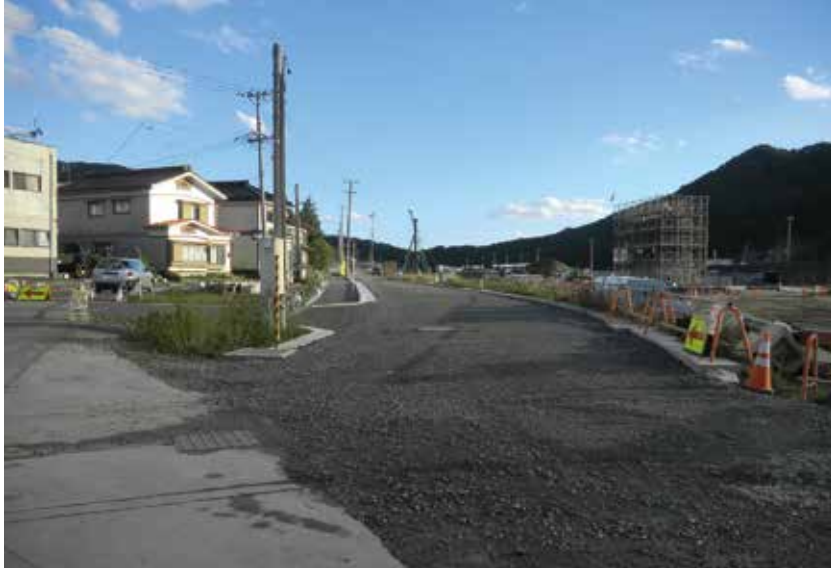
一日も早い舗装復旧が望まれる大浦地区
